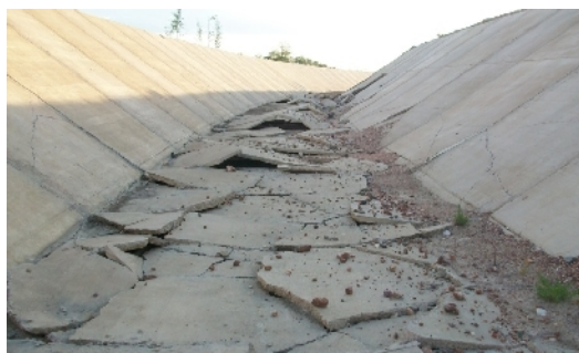
Vor Inbetriebnahme bereits unbrauchbar
